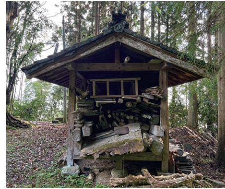
柱材であろう木が見えているのが痛みが気になる
